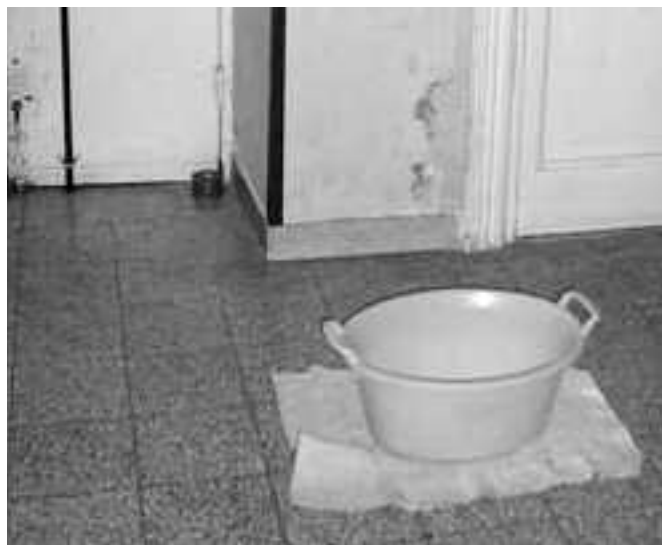
Bacinelle sul pavimento per raccogliere l'acqua che filtra dalle terrazze: un disagio senza fine per queste persone che non sanno ancora se queste case saranno loro
